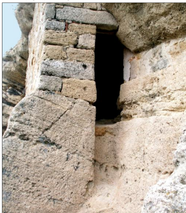
Fig. 9 : Cette photo permet de comprendre comment était calée l'étroite passerelle, une fois relevée.
