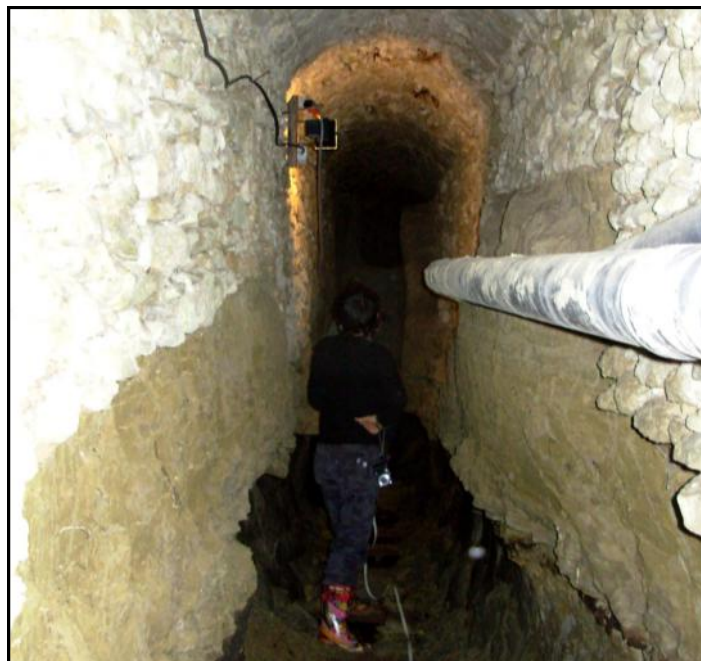
Photo de 2012. Le tuyau situé à environ 2,5 m au dessus du sol est aujourd'hui seulement 1,4 m au dessus du fond sableux et un barrage a créé une retenue d'eau
