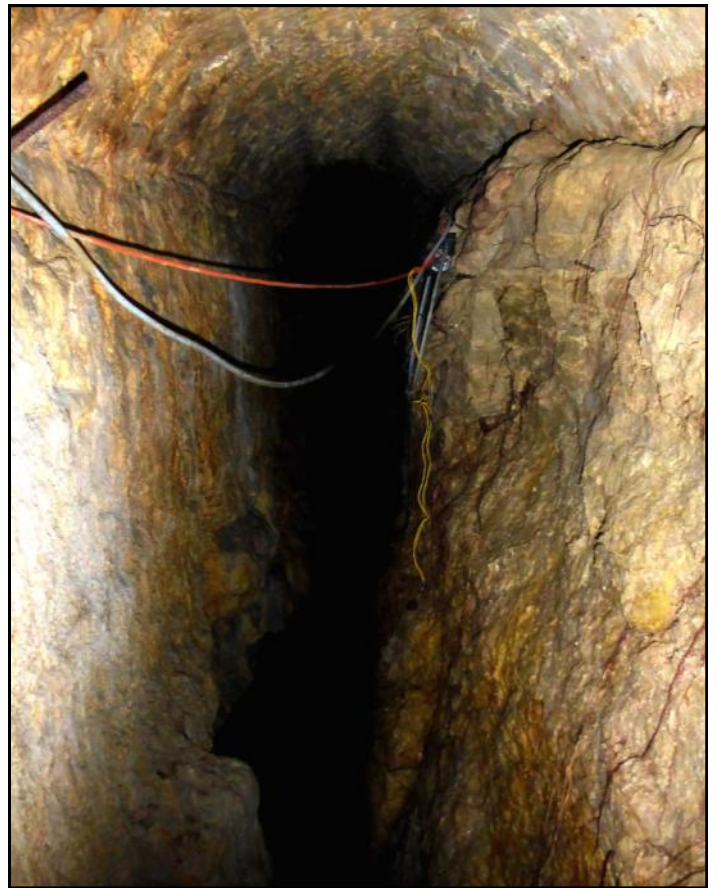
La diaclase rocheuse où se continue la mine est naturelle et ses parois calcifiées n'ont pas été taillées. Seul le plafond a fait l'objet d'une voûte maçonnée pour éviter que la chute de blocs instables ne puisse entraver l'écoulement de l'eau.
